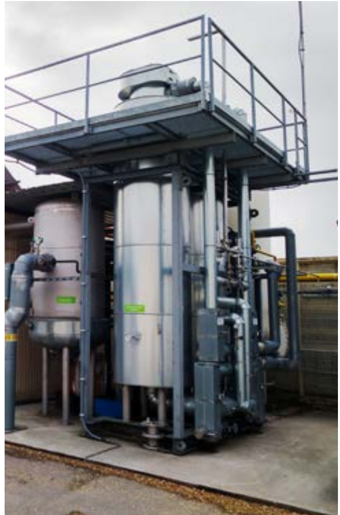
Abb. 43 Arbeitsbühne für Arbeiten an einem hoch gelegenen Arbeitsplatz einer Biogasaufbereitungsanlage
