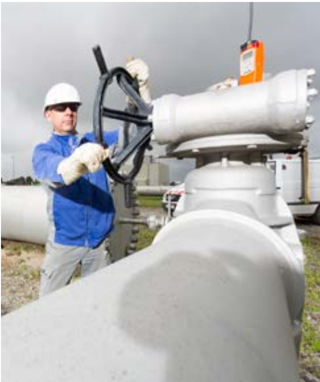
Abb. 9 Schließen einer Absperrarmatur
