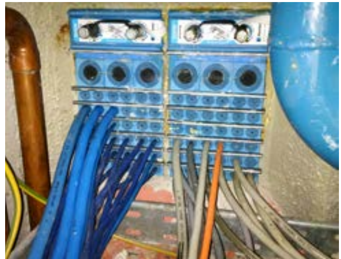
Abb. 30 Gasdichte Kabeldurchführungen aus dem EX-Raum in den Elektroraum vermeiden das Verschleppen von g.e.A.
