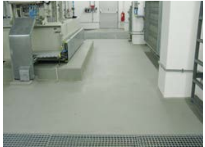
Abb. 39 Fußboden in einer Gas-Verdichterhalle (WHG-Aufbau, ableitfähig, rutschhemmend)
