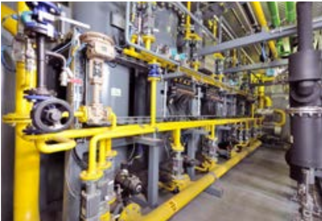
Abb. 18 Gasleitungen im Bereich einer Biogasaufbereitungsanlage
