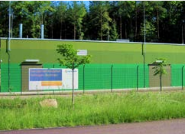
Abb. 14 GDRM-Anlage in einem Gebäude untergebracht
