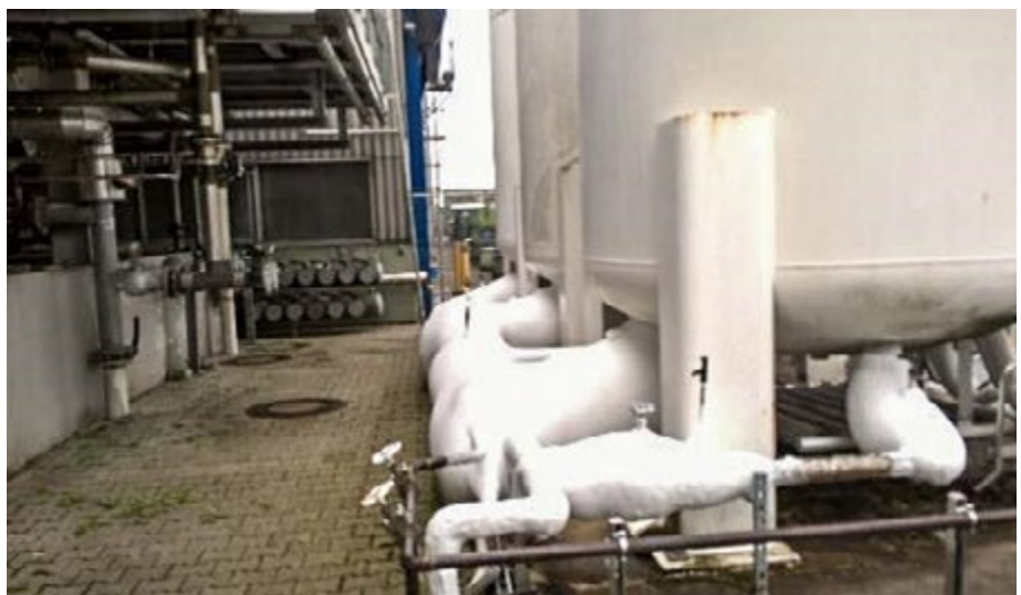
Abb. 31 Eisbildung an Rohrleitungen von Stickstofftanks
