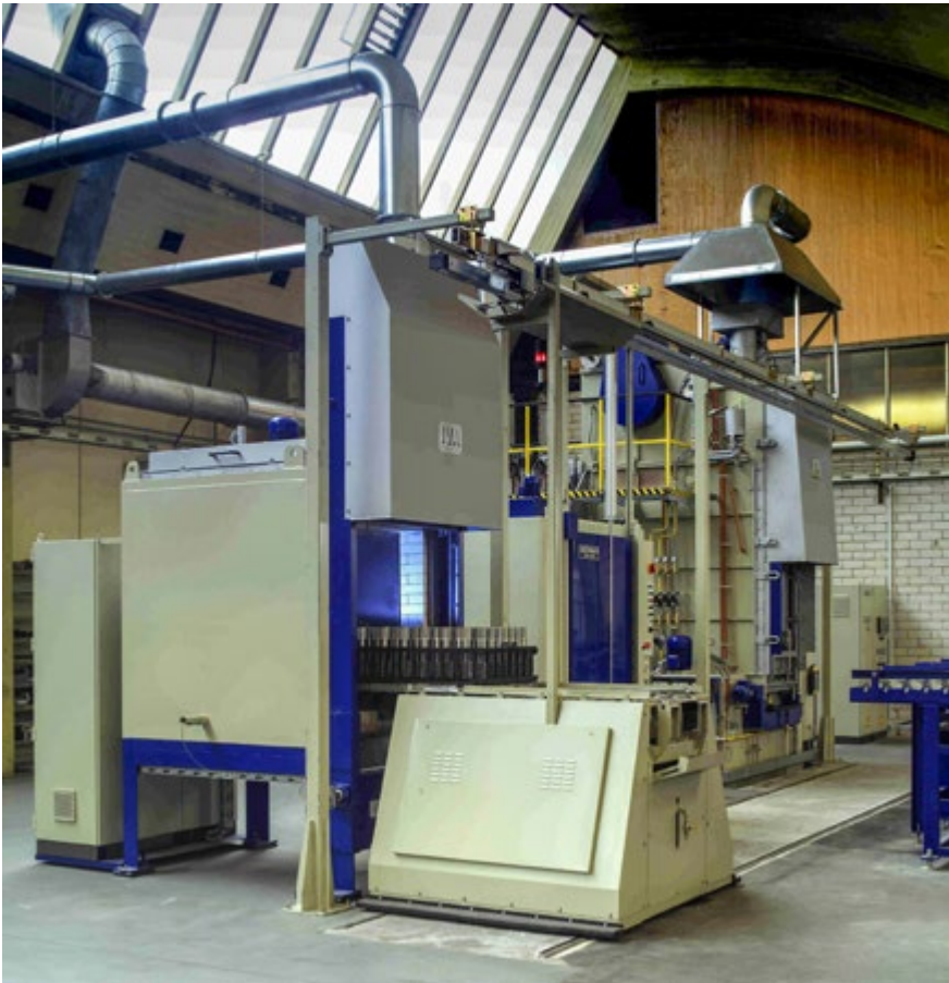
Abb. 36 Mehrzweckkammerofenlinie mit Anlassofen, Waschanlage und Mehrzweckkammerofen
