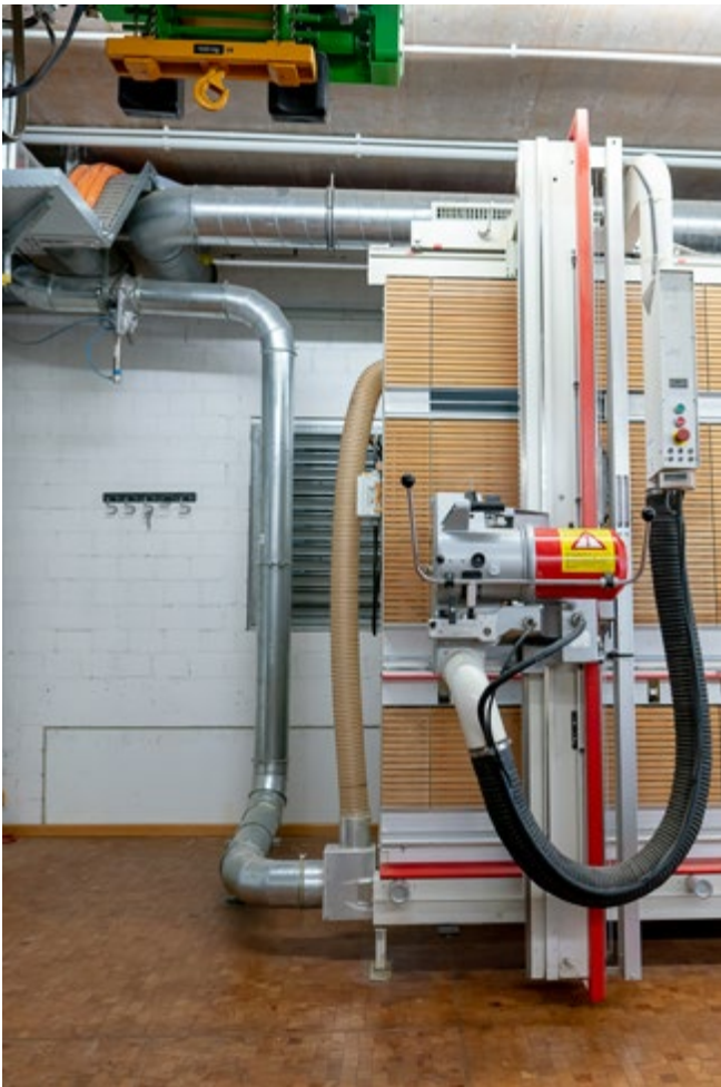
Abb. 3.1.2-07 Absauganlage an einer vertikalen Plattensäge
