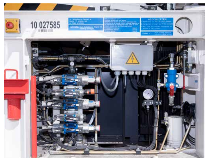
Abb. 2 Notablass mit Kurzanleitung
