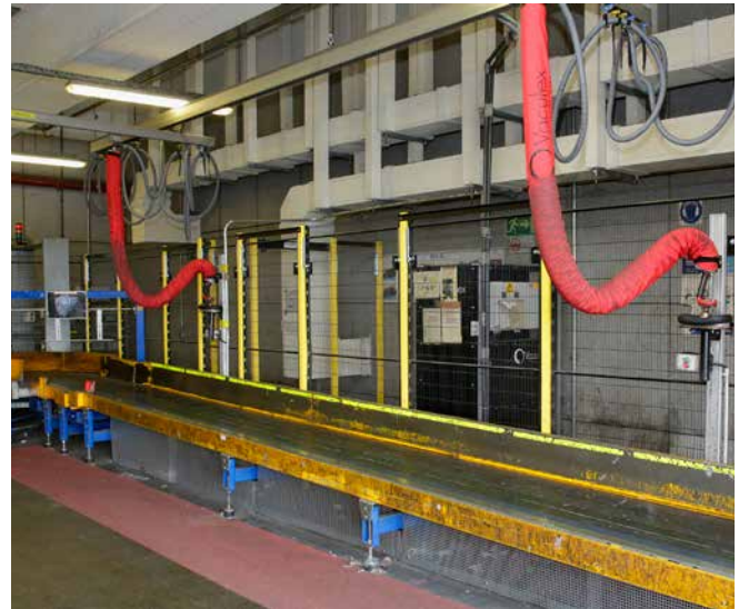
Abb. 67 Ergonomisch gestaltete Abnahmestelle mit abgeschrägtem Gepäckband und Ergomatte
