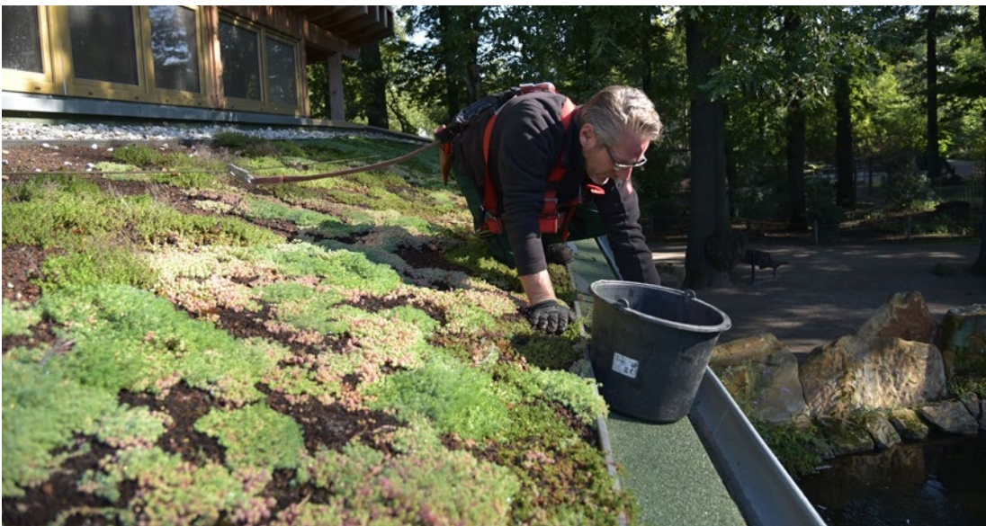
Abb. 55 Grünpflegearbeiten mit Absturzgefahr
