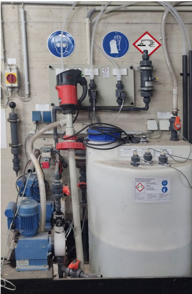
Abb. 40 Gefahrstoffe in der Wasseraufbereitung
