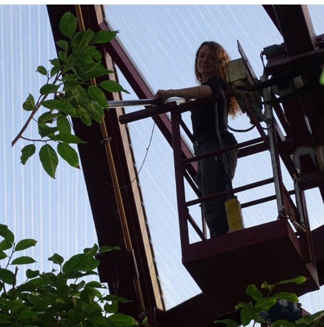
Abb. 47 und 48 Befahranlage zum Arbeiten in großer Höhe
