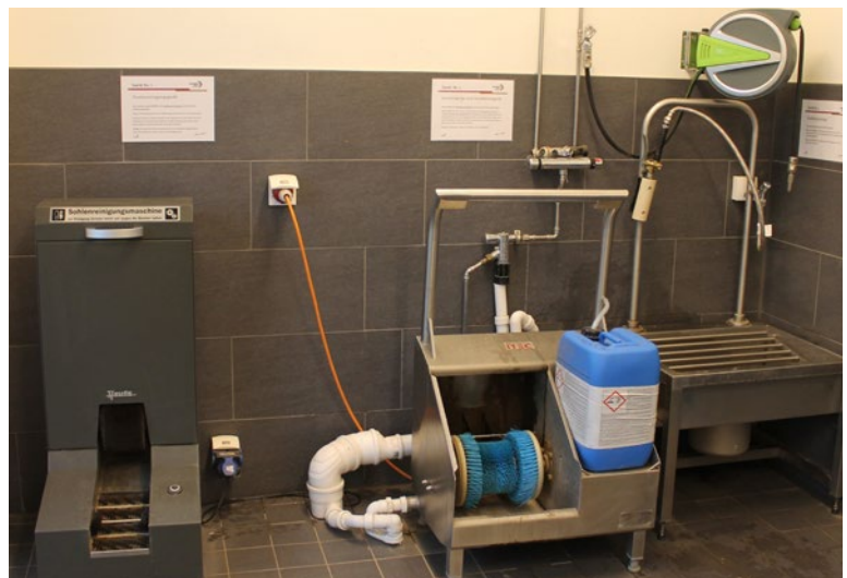
Abb. 65 Schuhreinigungs- und Desinfektionsanlage
