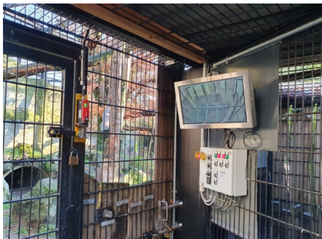
Abb. 15 Verriegelung einer Gehegetür durch eine Sicherheits-SPS
