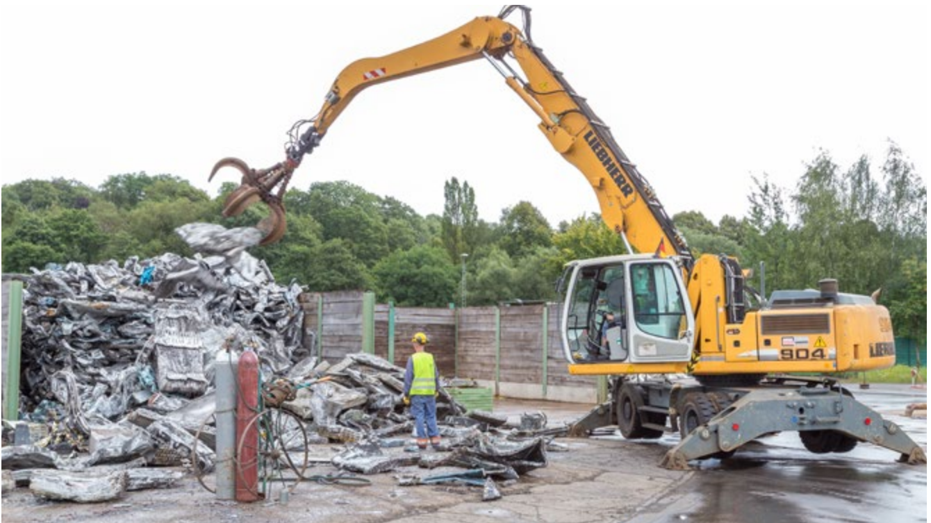
Abb. 27 Die Person vor dem Bagger trägt zwar Warnkleidung und Kopfschutz, ist aber durch ihren Aufenthalt im Gefahrenbereich durch herausfallende/herausgeschleuderte Teile aus dem Greifer gefährdet. Hinzu kommt noch die Gefährdung durch den fehlenden mechanischen Schutz der Gasflaschen (siehe auch Kapitel 3.3.4 Brennschneiden)
