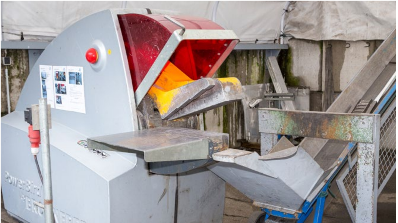
Abb. 82 Gut erreichbarer NOT-Halt-Taster und durchsichtiger Sicherheitskorb, die geschnittenen Teile werden hier über ein Förderband abtransportiert.
