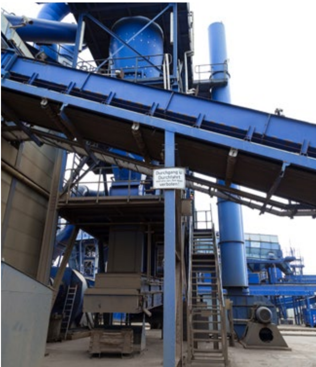
Abb. 65 Aufstiege mit Wartungsplattformen mit rutschfesten Gitterrostplatten und Absturzsicherungen an der Entstaubungsanlage
