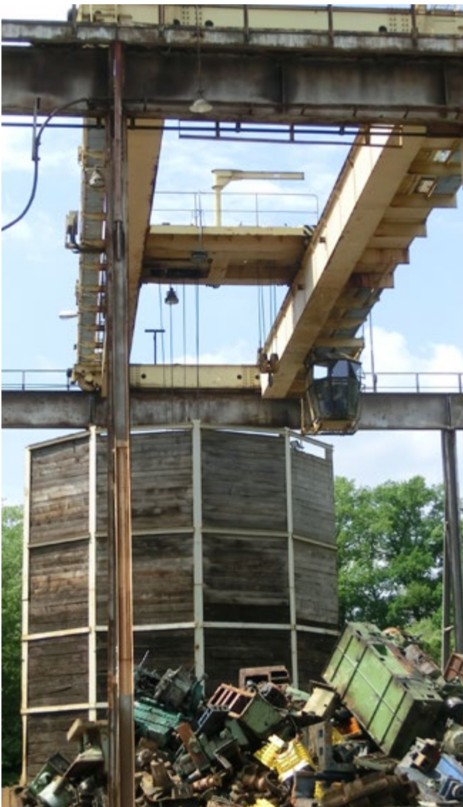
Abb. 48 Intakte Schutzwand eines Fallwerkes
