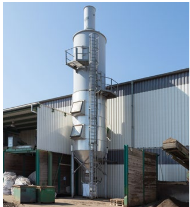
Abb. 84 Schlauchfilter mit Berstscheiben und Begleitheizung zur Minimierung der Auswirkungen einer möglichen Staubexplosion
