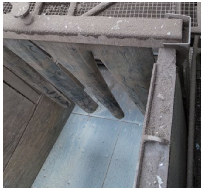
Abb. 68 Gummilamellen vor der Einlauföffnung als Schutzeinrichtung gegen zurück schleuderndes Schreddergut
