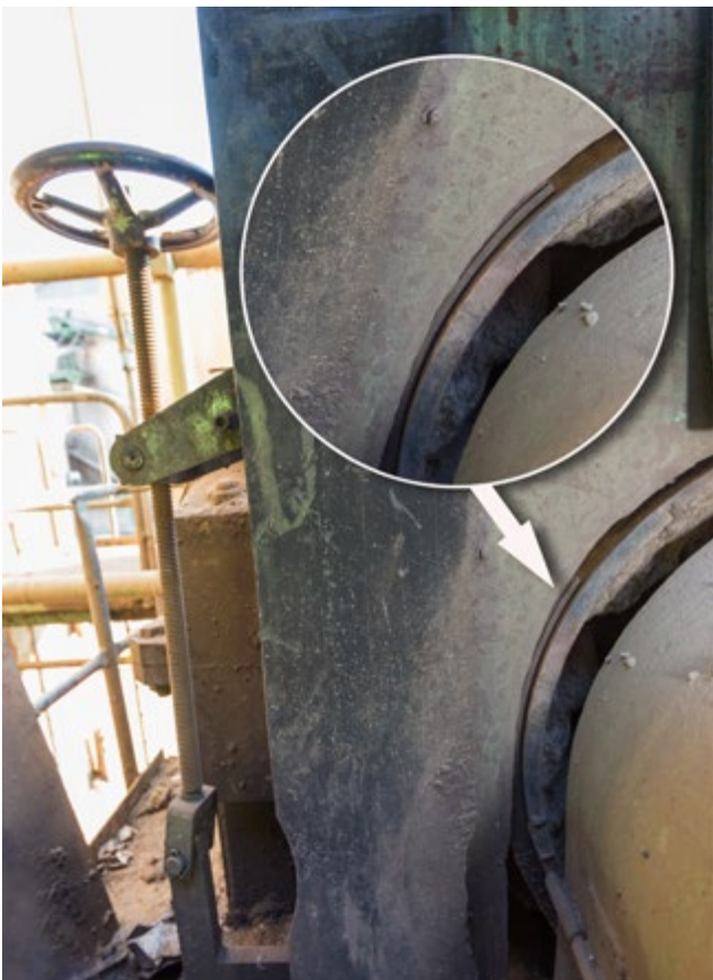
Abb. 62 Bremse an der Welle des Hammerbrechers
