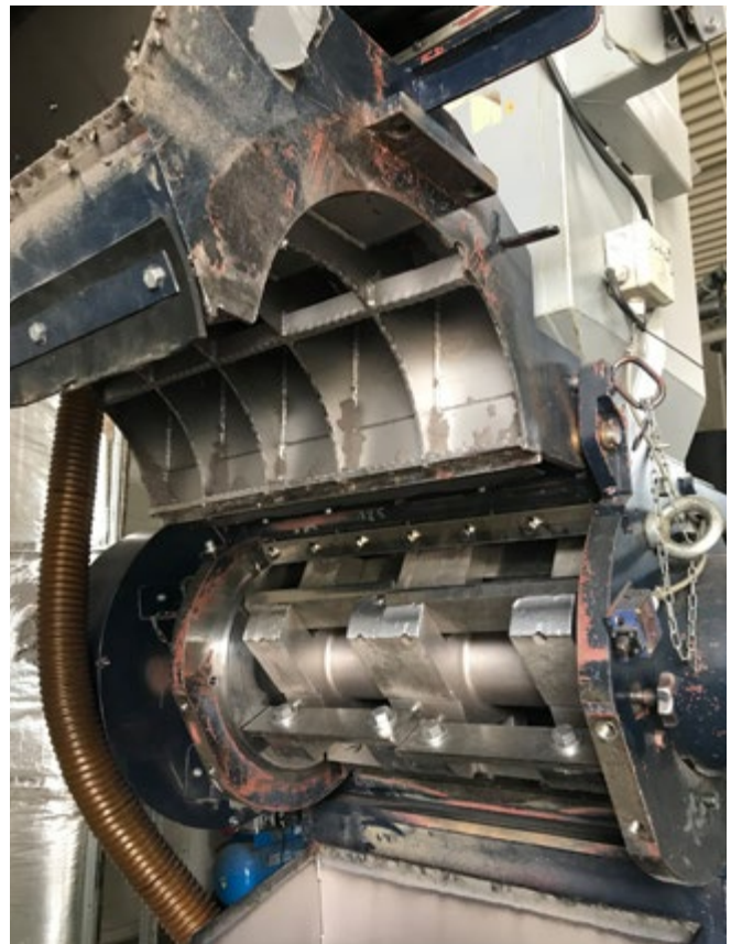
Abb. 104 Zusätzliche mechanische Sicherung am Gehäuse des Kabelgranulierers gegen unbeabsichtigtes Absenken des Deckels
