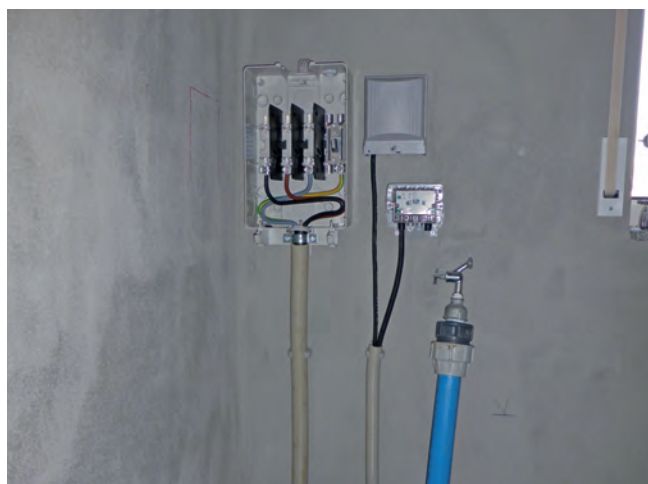
Abbildung B.57: Hausanschlusskasten angeschlossen
