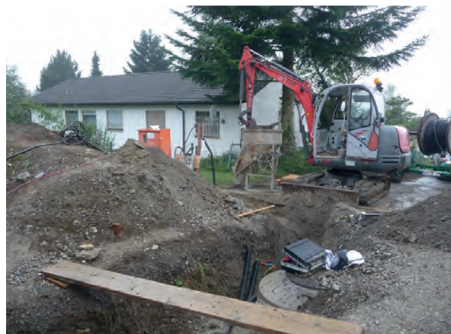
Abbildung B.54: Minibagger der Kolonne
