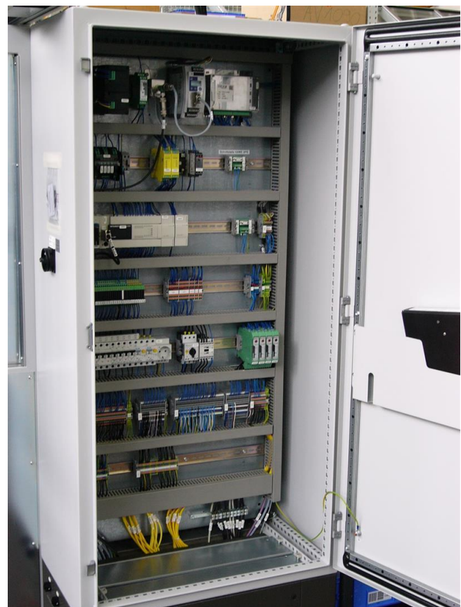
Bild 11: Geöffneter Schaltschrank eines Prüfstands
