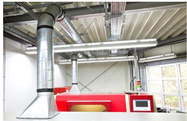
Bild 12: Absaugung an Prüfständen
