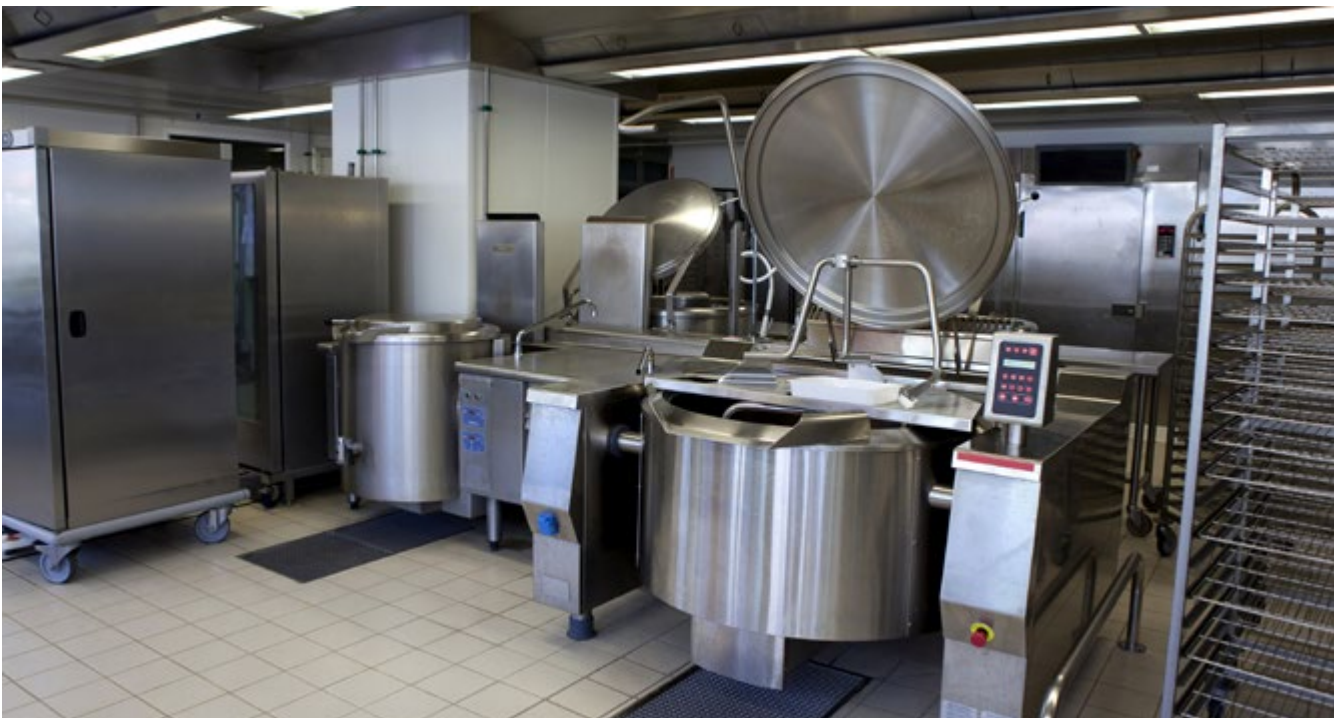
Abb. 37 Der Einsatz von Geräten mit Fettdampf und Wasseranfall macht eine Abluftanlage erforderlich.
