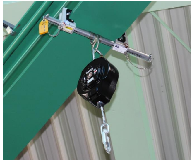
Bild 2: Temporäre Anschlageneinrichtung mit einem Einzelanschlagpunkt an der Krankonstruktion
