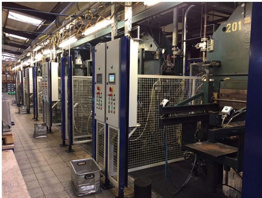
Bild 5: Nachgerüstete Maschinen mit Lichtschranken als Zugangssicherung ergänzt durch Quittiersystem
