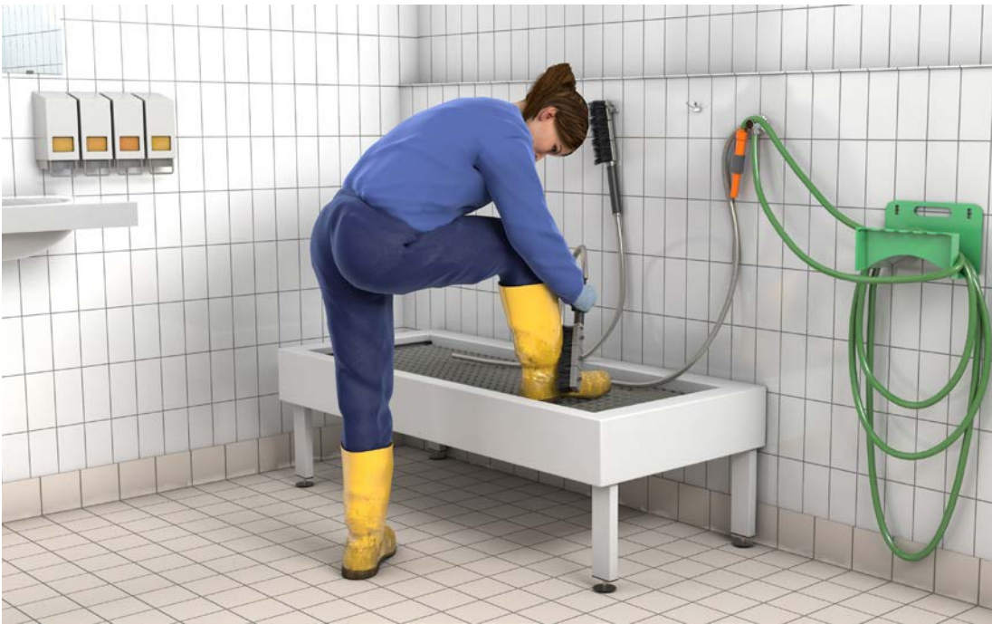
Abb. 4 Die Stiefelwaschanlage sorgt dafür, dass Beschäftigte den Schmutz nicht in die betrieblichen Räume tragen.
