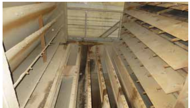
Abb. 79 Geöffnete Siebanlage mit noch nicht abgedeckten Heißmineraltaschen
