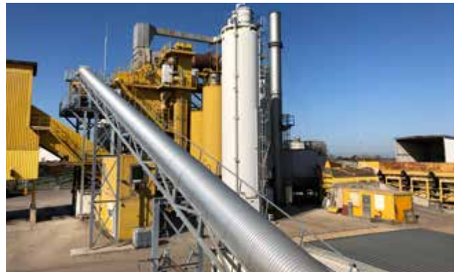
Abb. 61 Abgedecktes Förderband für die Zugabe von Asphaltgranulat in den Mischer über Kaltzugabe
