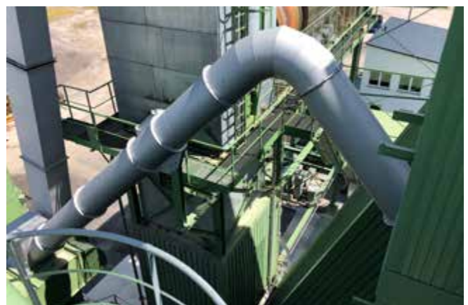
Abb. 62 Expansionsrohr zur Ableitung des Dampfstoßes vom Mischer zur Entstaubungsanlage.
