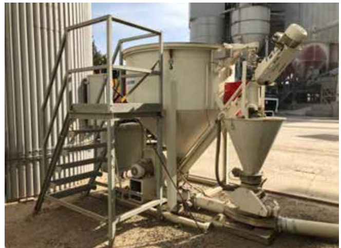
Abb. 48 Vorratsbehälter einer Faserstoffzugabe mit sicherem Podest zur Öffnung der Big Bags.
