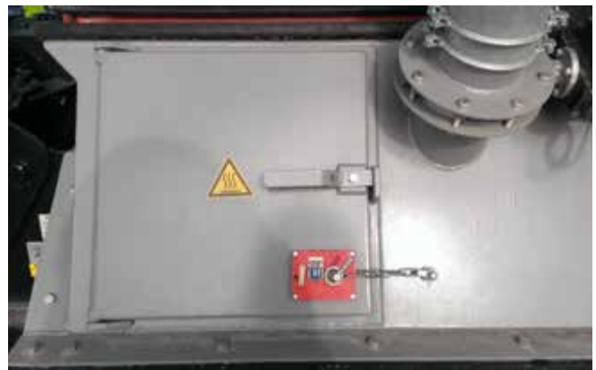
Abb. 47 Schlüsseltransfersystem an einer Wartungsluke in der Mischerhaube
