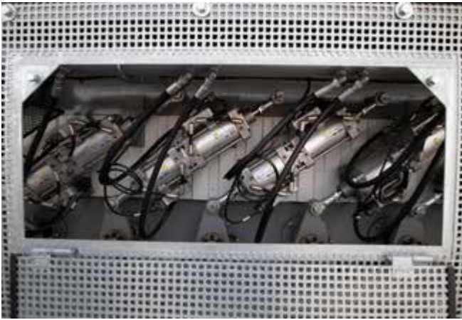
Abb. 43 Geöffnete Schutzabdeckung über pneumatischen Schließzylindern
