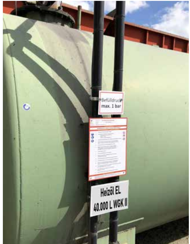
Abb. 21 Kennzeichnung Tank und Betriebsanweisung gut sichtbar angebracht
