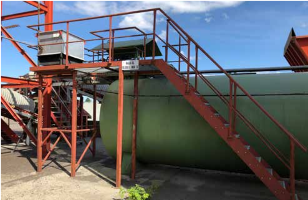
Abb. 74 Zugang zum Dom-Deckel des Heizöltanks
