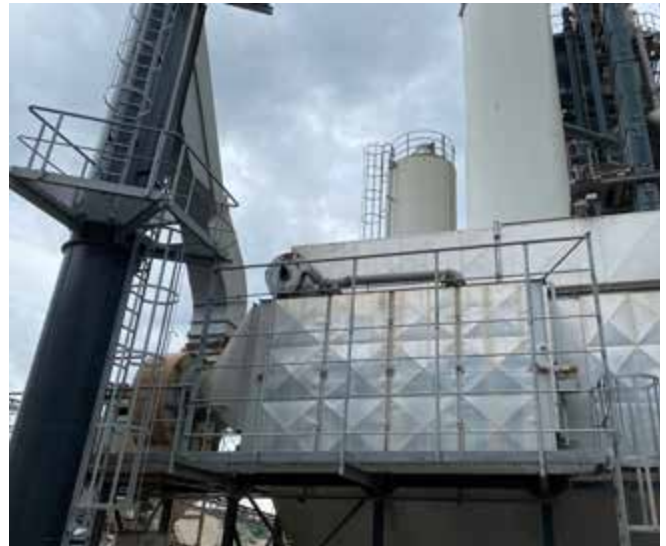
Abb. 40 Erhöhte Geländer auf der Wartungsbühne der Filteranlage
