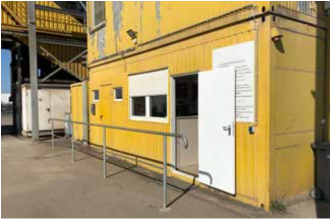
Abb. 2 Barriere zwischen Fahrweg und Tür
