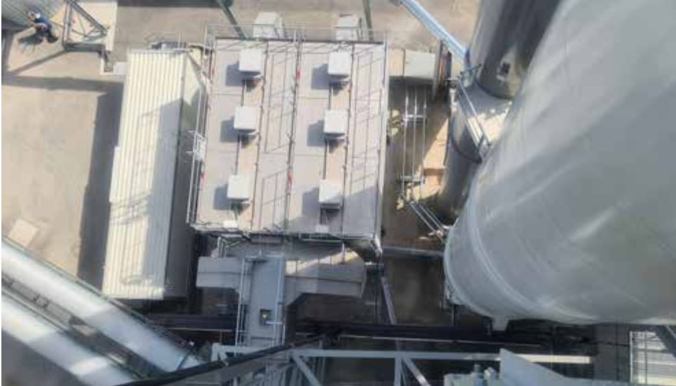
Abb. 77 Wartungsbühne der Filteranlage mit Absturzsicherung
