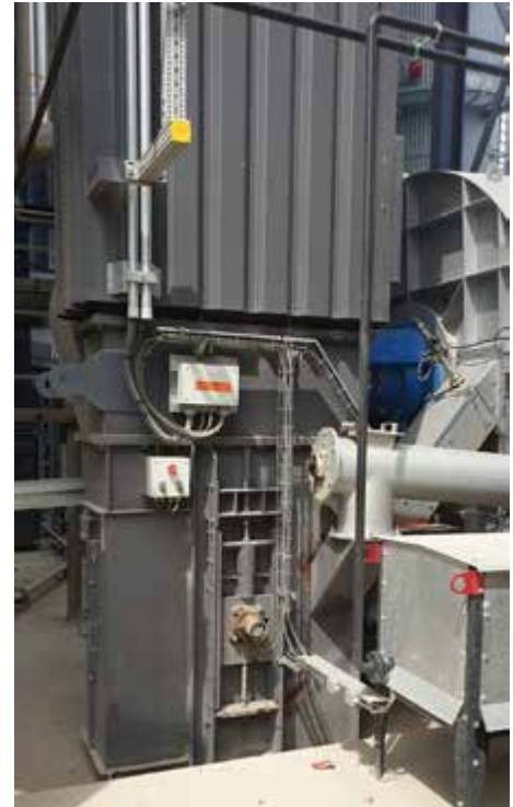
Abb. 34 Becherwerk mit Isolierung
