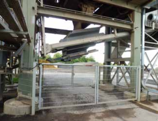
Bild 64 Direktverladung, durch trennende, bewegliche Schutzeinrichtung mit elektrischer Verriegelung gesichert.
