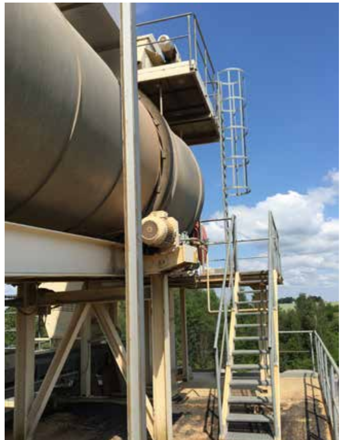
Abb. 58 Sichere Verkehrswege an hochgelegener Paralleltrommel
