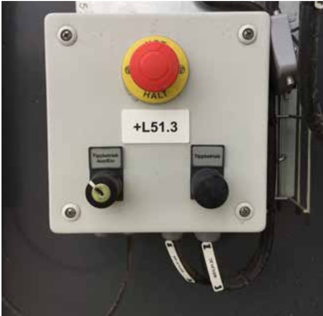
Abb. 67 Vor Ort Steuerung Becherwerk
