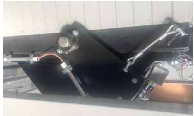
Abb. 70a Stahlseilsicherung einer Auslaufklappe
