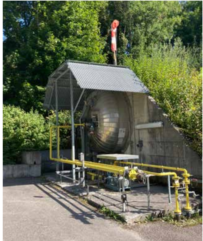
Abb. 24 Flüssiggastank mit Beton-Schildwand im Erdhügel gesichert, Tankkopf und Armaturen überdacht
