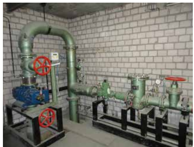
Abb. 23 Erdgasanschluss in Übergabestation
