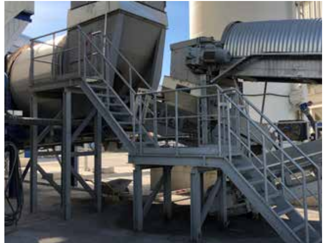
Abb. 75 Treppe und Arbeitsbühne als Zugang zur Wartungsklappe
