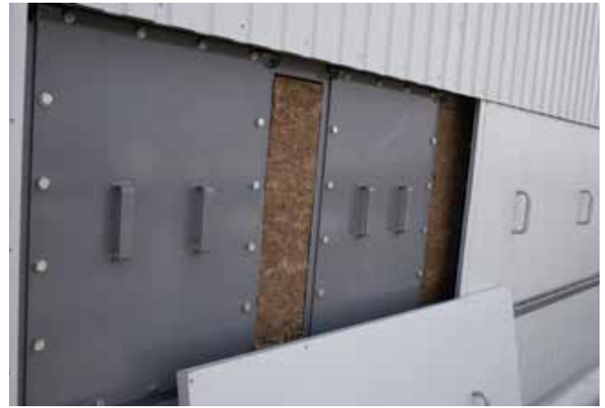
Abb. 44 Isolationsabdeckungen und Wartungsluken eines Heißsilos zum Schutz vor Kontakt mit heißen Oberflächen
