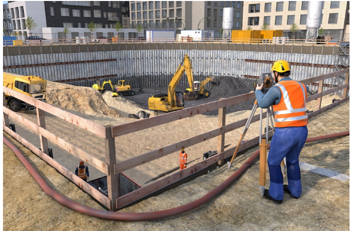
Abb. 22 Dreiteiliger Seitenschutz als Absturzsicherung
