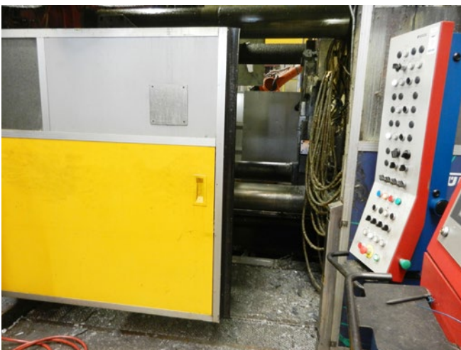
Abb. 21 Schutztür mit Schließkantensicherung
