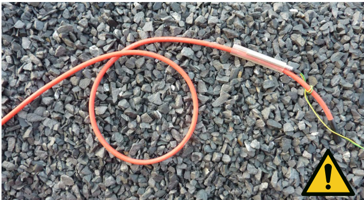
Abb. 24 Unzulässige Verlegung von Sprengschnur in einer Schlinge
