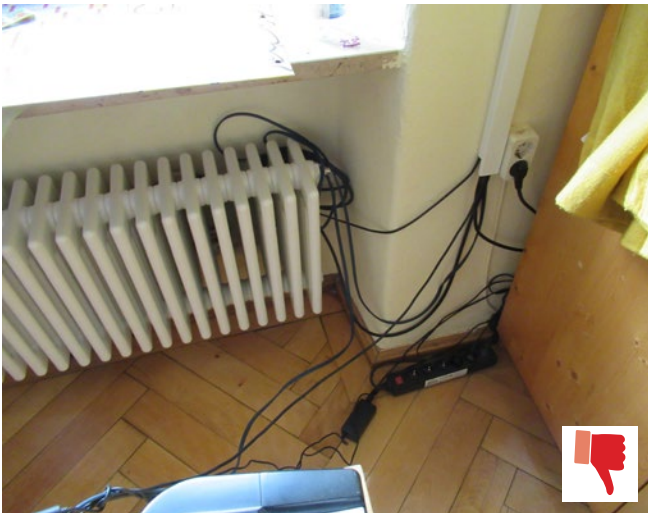
Abb. 2 Negatives Beispiel: Kabel, die hinter Heizkörpern verstaut sind, werden (hohen) Temperaturschwankungen ausgesetzt und ihre Ummantelung kann dadurch spröde und rissig werden. Zudem stellen die Kabel Stolperfallen dar.
