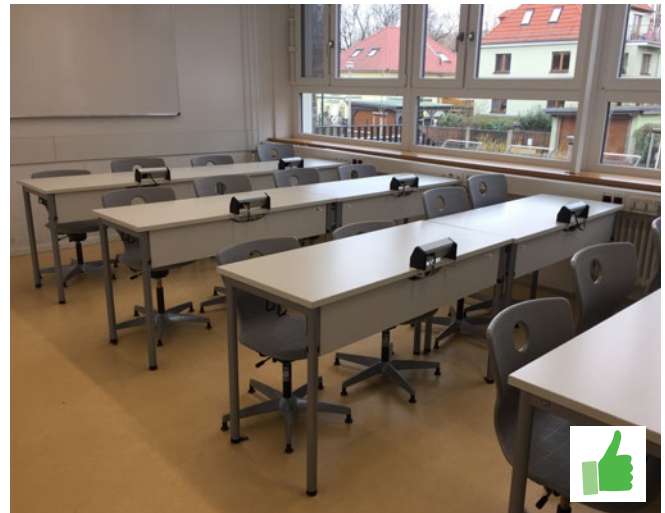
Positives Beispiel: In Schultische integrierte Steckdosen schützen die Verkabelung und tragen zur Vermeidung von Stolperstellen bei. Hilfreich ist auch die Ergänzung einer USB-Ladeleiste oder eines LAN-Anschlusses.
