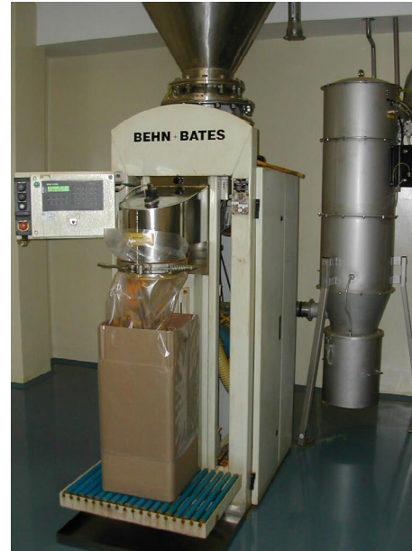
Abbildung 28: Abfüllplatz mit Absaugung
