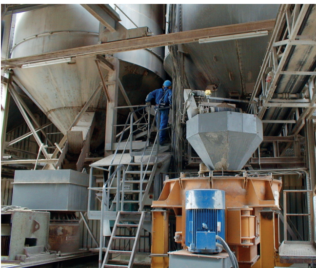
Abbildung 1: Brecheranlage im Kieswerk
