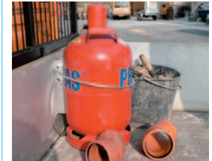
Bild 4-14: Kleinflasche mit Schutzkappe, durch eine Halterung gegen Umfallen und Herabstürzen gesichert (Quelle: Marotech)
