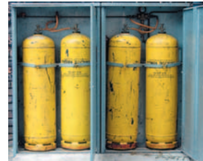
Bild 4-10: Verschließbarer, belüfteter Flaschenschrank an einer Gebäudeaußenwand
