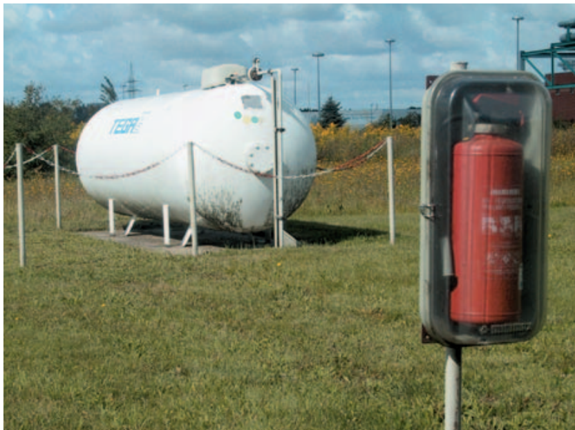
Bild 3-2: Oberirdisch aufgestellter Flüssiggasbehälter in sicherem Abstand zu Verkehrswegen auf einem Betriebsgelände
