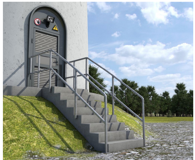
Abb. B1-1 Sicherer Zugang zur Anlage
