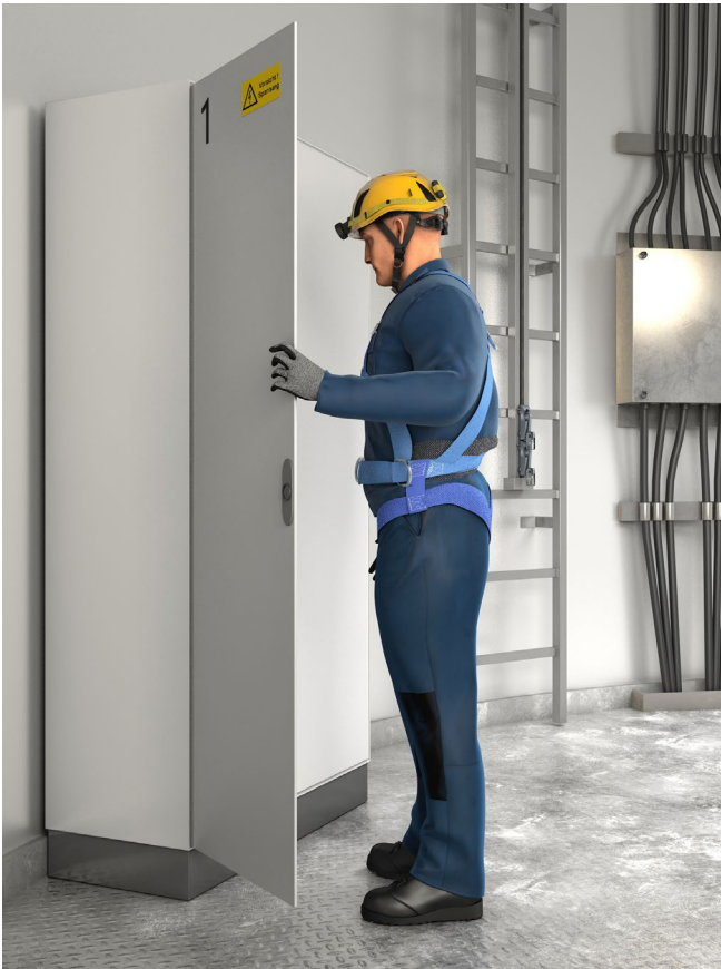
Abb. A12-1 Schaltschrank
