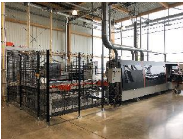
Abbildung 13 – Beispiel einer Zugangssicherung des Querschiebers am Maschinenauslauf
