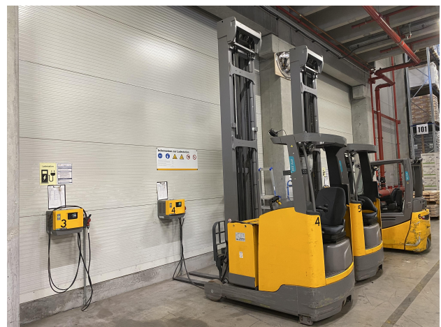
Abbildung 1: Ladestationen für Gabelstapler
