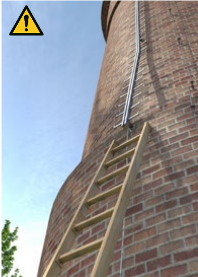
Abb. 4 Unsichere Zugangssituation bei Steigleitern am Schornstein
