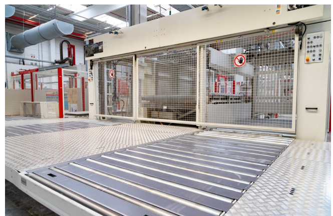
Abb. 35 Füllbleche an einem Rollenförderer
