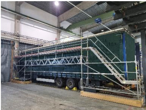
Abbildung 22 – Laufsteggerüst in Modulbauweise Fertig konfektioniertes Gerüst, wird im Verladebereich stationär bereitgestellt
