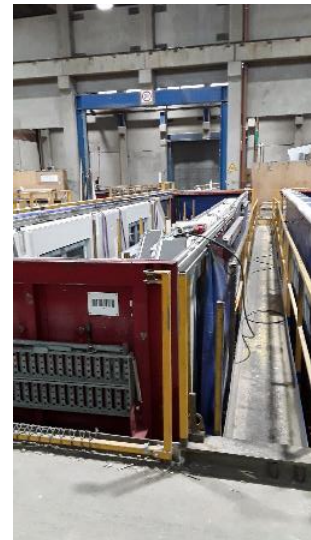
Abbildung 17 – Laufstege im Verladebereich Keine Absturzgefahr durch Seitenschutz
