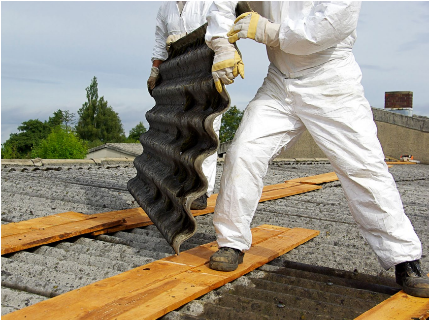
Beschäftigte können auch heute noch bei der Entsorgung bzw. bei Renovierungsarbeiten gegenüber Asbest exponiert sein.
