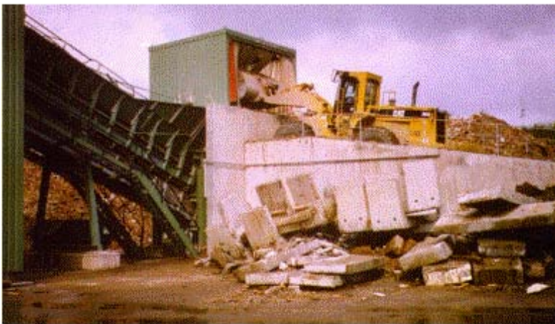
Abb. 13: Auffahrrampe mit seitlichem und vorderem Anfahrerschutz
