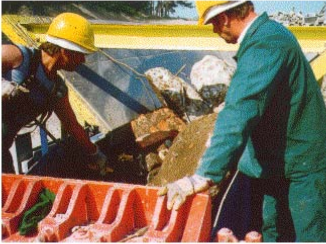
Abb. 14: Sortierarbeiten am Brechereinlauf mit erhöhter Gefährdung und Gesundheitsbelastung
