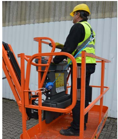
Bild 9-3 Einsatz von PSA gegen Absturz
