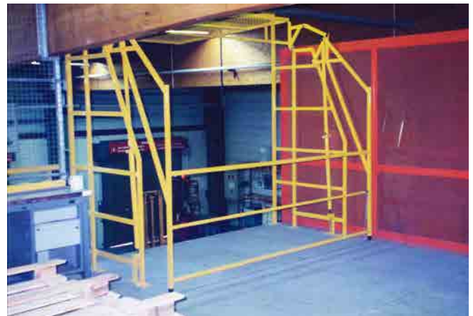
Abb. 42 Sicherheitsschleusengeländer für sichere Schnittholzübergabe
