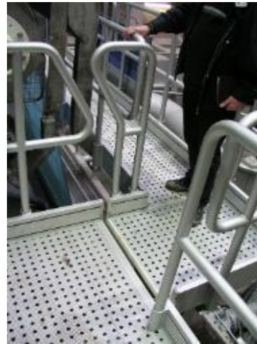
Abbildung 43 – Geeignete Öffnung an den Geländerelementen und Durchführspalt im Laufsteg
