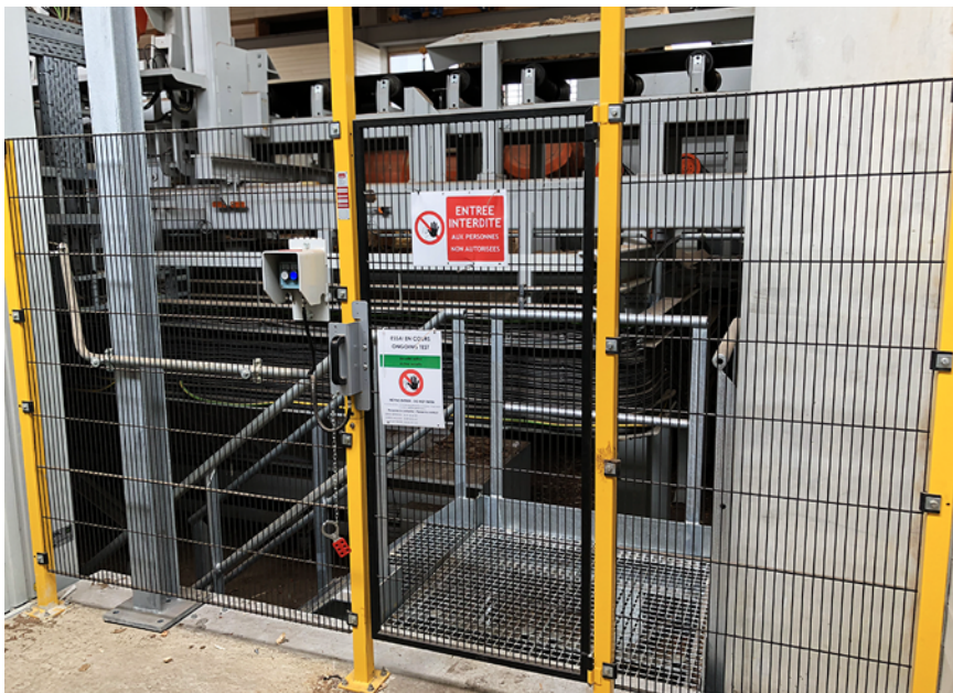
Abb. 52 Elektrisch verriegelte Zugangstür
