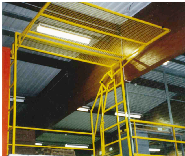
Abb. 59 Sicherheitsschleusengeländer für sichere Schnittholzübergabe
