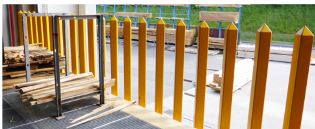
Abb. 57 Absturzsicherung durch Palisaden aus Stahl an erhöhtem Stapelplatz mit Übergabebereich
