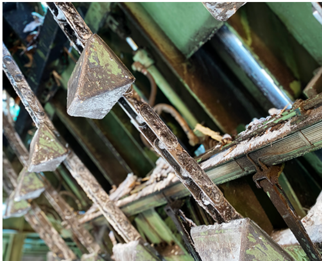
Abb. 55 Zentralschmierung am rücklaufenden Kettenstrang eines Vereinzelers
