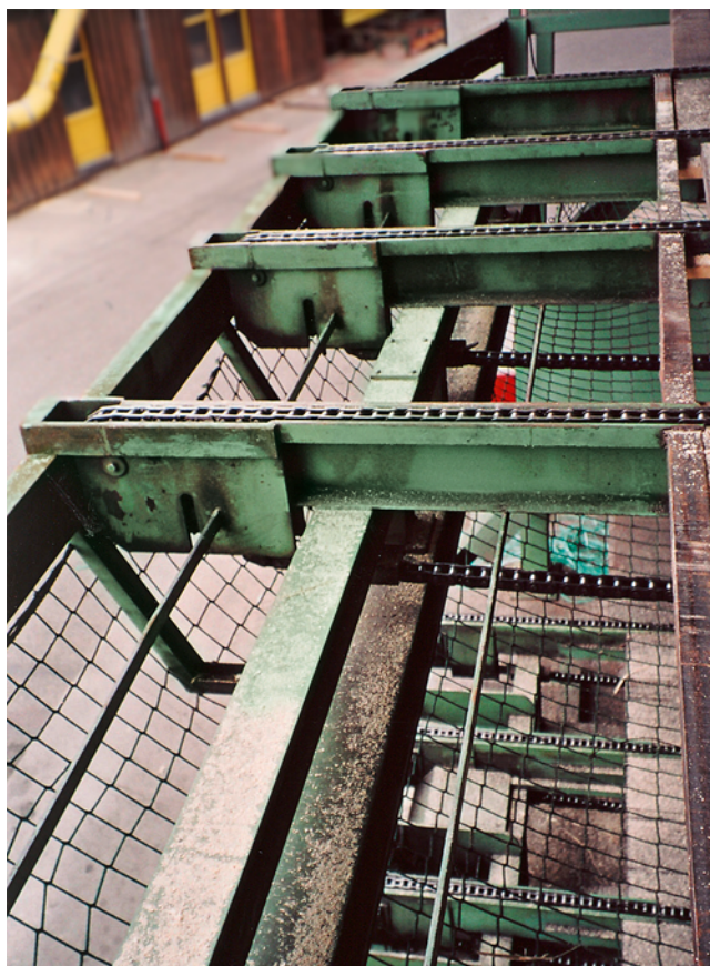
Abb. 60 Netz als Absturzsicherung an erhöhten Stapelbereichen
