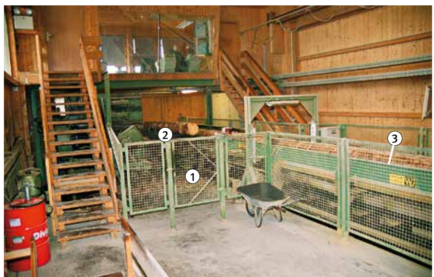
Bild 49: Querförderer mit Einleger zur Einschnittlinie
