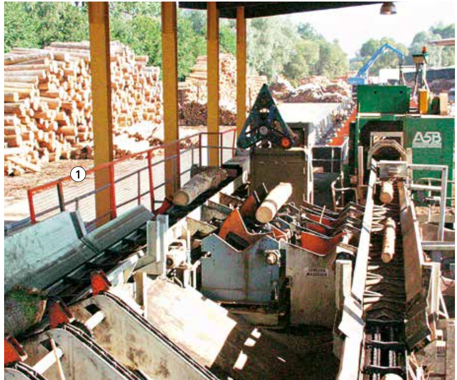
Bild 17: Umzäunung eines Wurzelreduzierers mit elektrisch verriegelter Zugangstür und Zuhaltung bei einer Auslaufzeit der Fräswelle von mehr als 10 s
