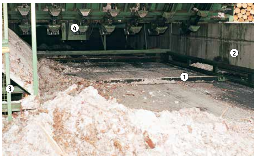
Bild 38: Entsorgung über den gesamten Aufgabe- und Vereinzelnbereich
