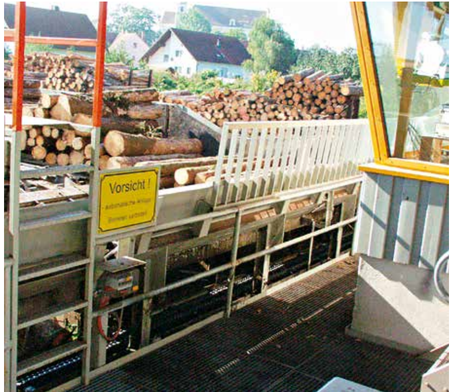
Bild 19: Sicherung der Stamm-Einwurfstelle durch massive Streben und wannenförmige Seitenwangen am Blockzug
