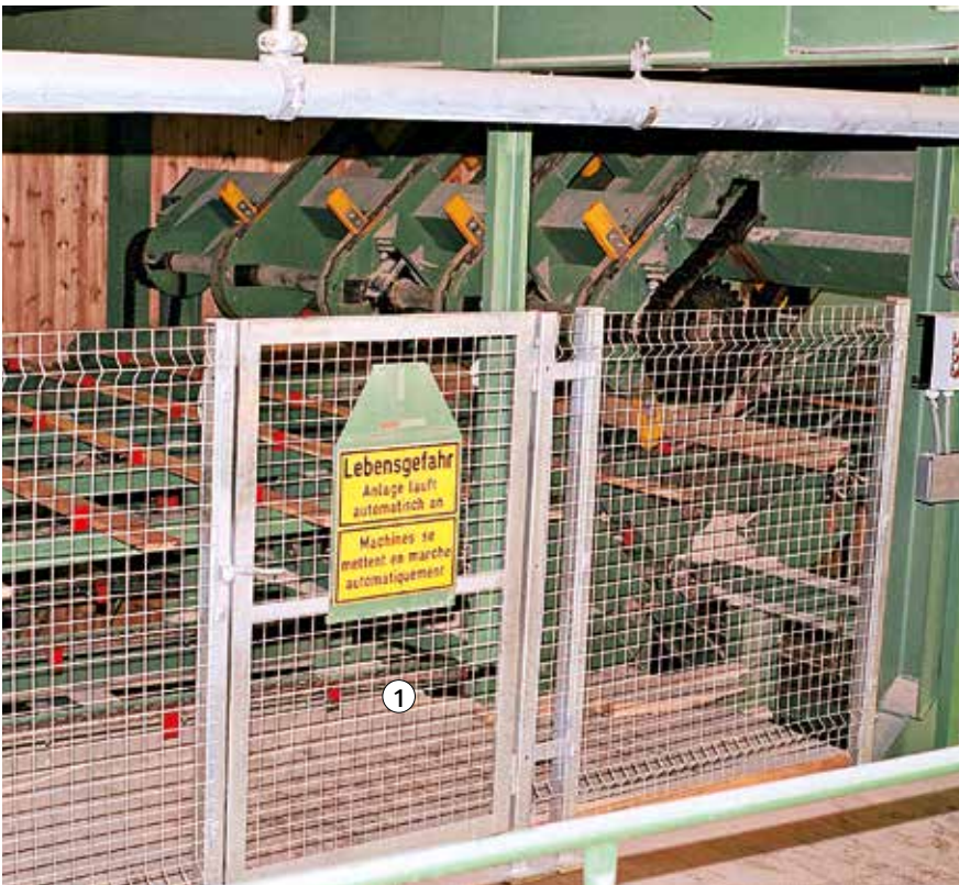
Bild 19: Querförderer zwischen Trimmersägen und Sortierförderer
