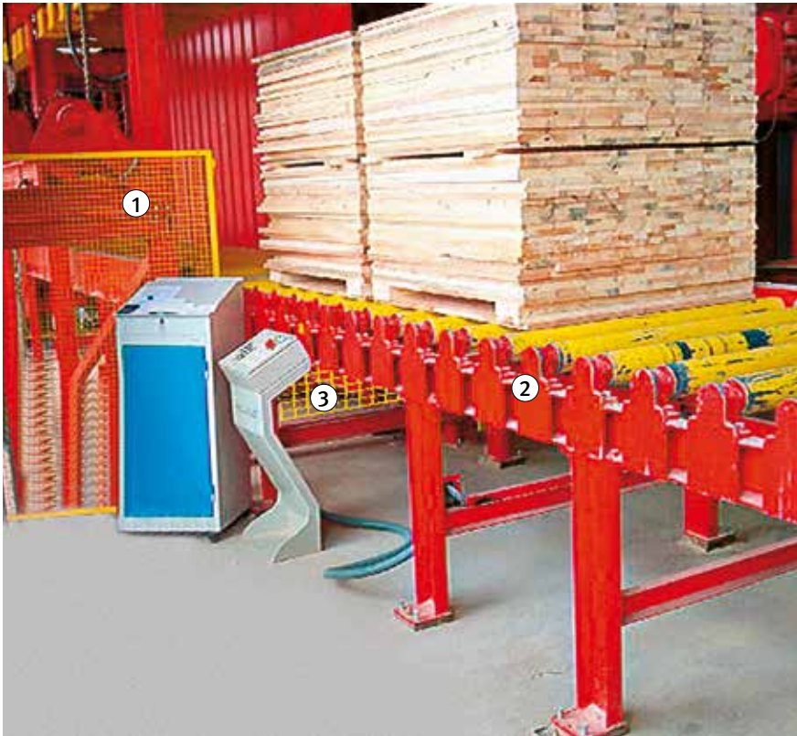
Bild 39: Ausführungsbeispiel Rollengang als Teil der Zugangssicherung zum Gefahrenbereich einer Stapelanlage
