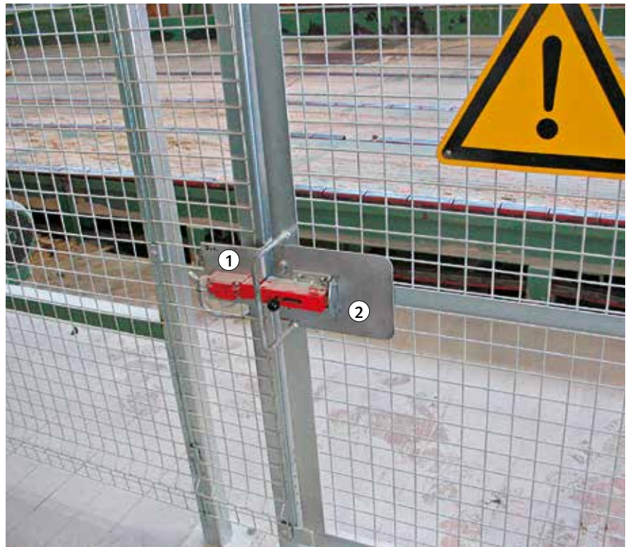
Bild 41: Elektrisch verriegelte Zugangstür
