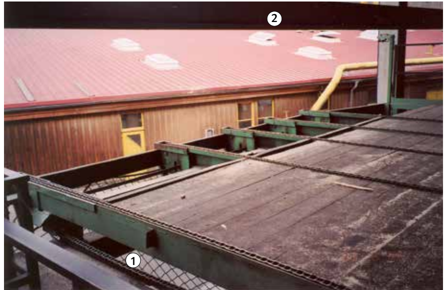
Bild 2: Absturzicherung an erhöhten Stapelbereichen
