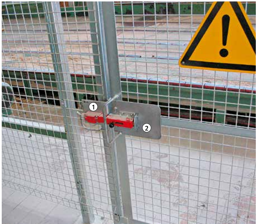
Bild 41: Elektrisch verriegelte Zugangstür
