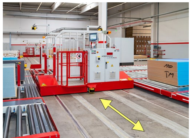
Abb. 84 Querverschiebewagen mit Laserscanner
