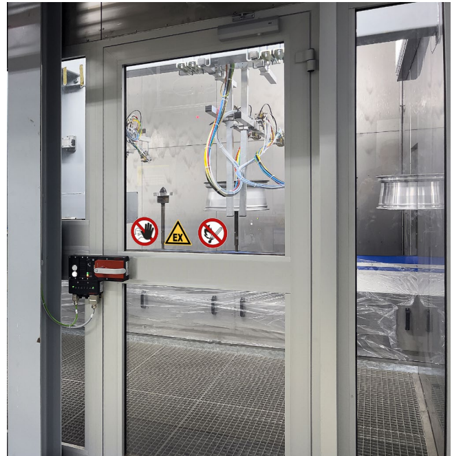
Abb. 23 Kennzeichnung an einem Zugang zu einer Lackierkabine
