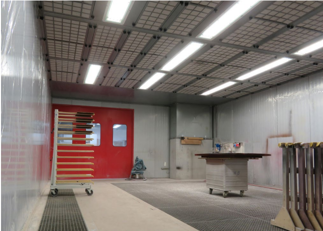
Abb. 48 Lackierraum mit eigenem Trocknungsraum
