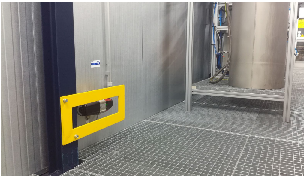
Abb. 27 Gaswarneinrichtung im Farbversorgungsraum (mit Anfahrschutz)
