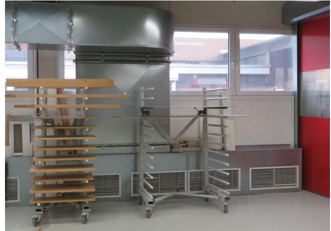
Abb. 49 Hordenwagen im Abdunst- und Ablüftungsbereich
