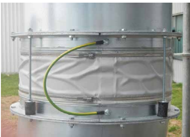
a) Kompensator in Zuluft-Leitung
