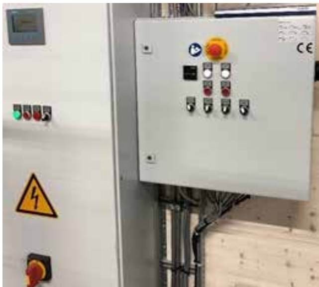
Abb. 84 Steuerungsschrank mit Hauptschalter und Not-Halt
