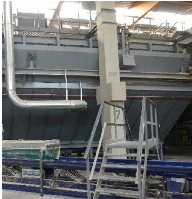
b) Verlauf der Anschlussrohrleitung (links) von der auf dem Hallendach positionierten Filteranlage zur Absaugung der Blockbandsäge im Bereich der Späne-Entsorgung unterhalb der Sägeebene
