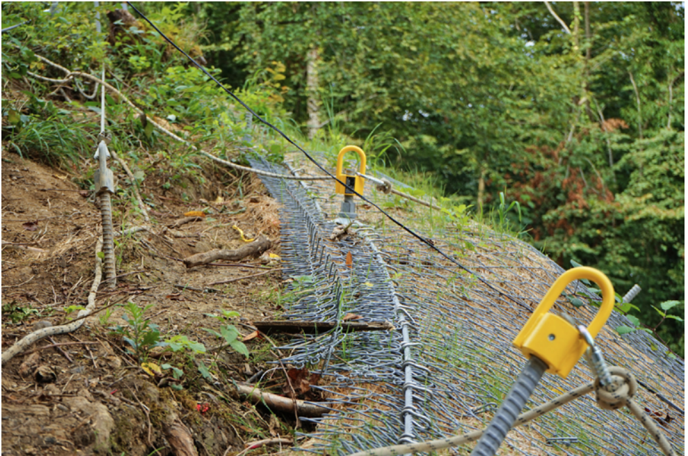
Abb. 16 Felsanker mit Anschlagvorrichtung für PSA gegen Absturz
