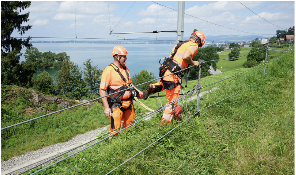
Abb. 21 Sicherung an einer Anschlagseinrichtung (Lifeline) bei sich kreuzenden Arbeitswegen
