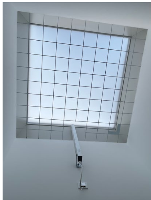
Abb. 11 Unterspannung an Öffnung Lichtkuppel
