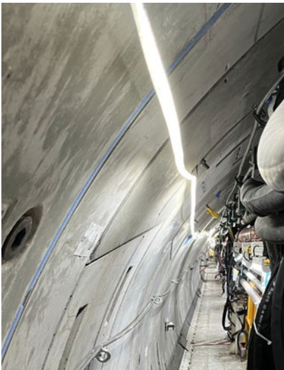
Abb. 20 Beleuchtung mit LED Lichtband
