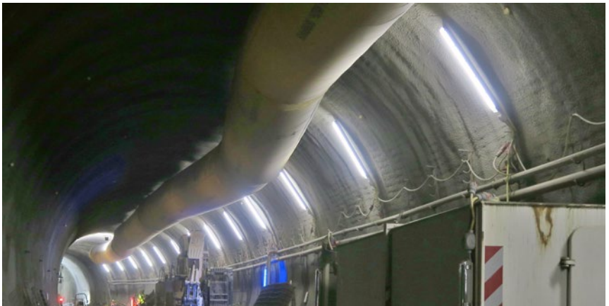
Abb. 18 Wegen Verstaubung werden Leuchten senkrecht angebracht
