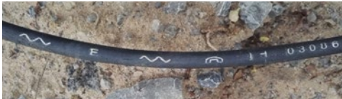
Abb. 2 Glasfaser-Telekommunikationsleitung mit „Wellenlinie“
