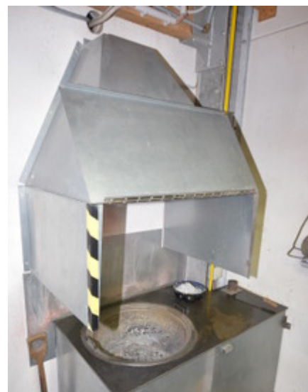
Abbildung 1: Kessel zum Schmelzen von Blei mit Absaugung
