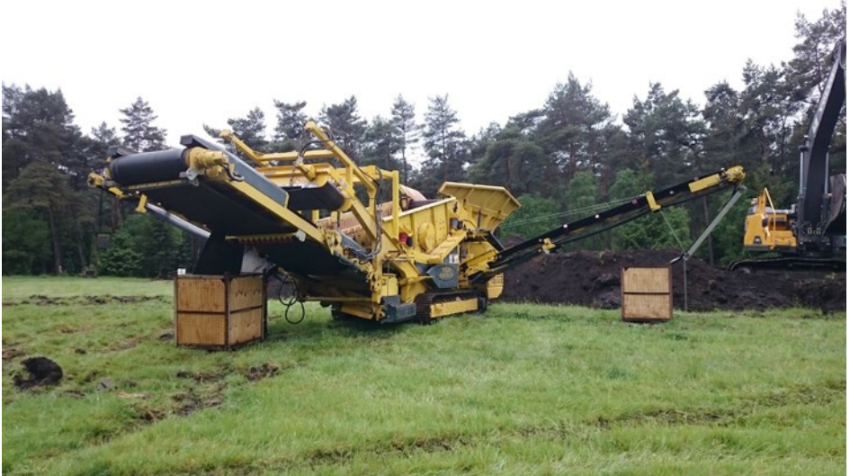
Abb. 14 Separieranlage für die maschinelle Volumenräumung/Separation
