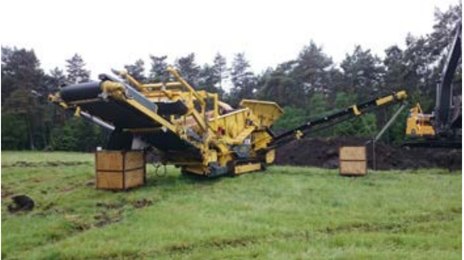
Abb. 14 Separieranlage für die maschinelle Volumenräumung/Separation
