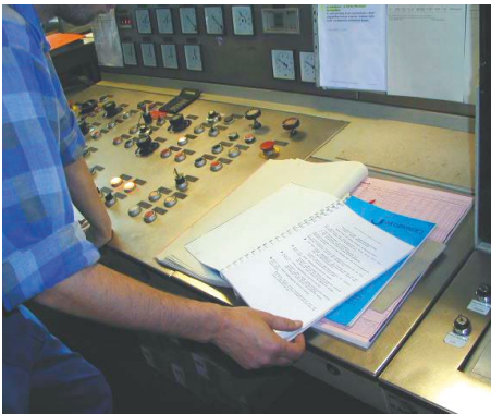
Abb. 43 Wird die Betriebsanleitung in der Schaltwarte aufbewahrt, ist sie leicht zugänglich und die Bedienperson wird sie im Zweifelsfall auch benutzen.
