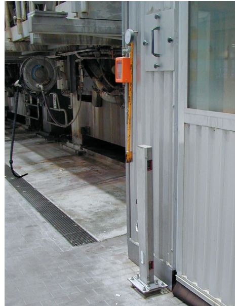
Abb. 6 Zwei Lichtschranken sichern über die gesamte Länge der Trockenhaube die Quetschstelle zwischen den Hubtoren und dem Flur.
