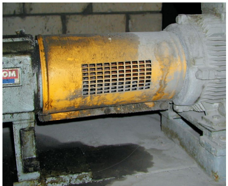
Abb. 5 Die sich drehenden Teile stellen eine Fangstelle dar und sind durch Verkleidung gesichert. Die feststehende trennende Schutzeinrichtung ist verschraubt und lässt sich nur mithilfe von Werkzeug entfernen.
