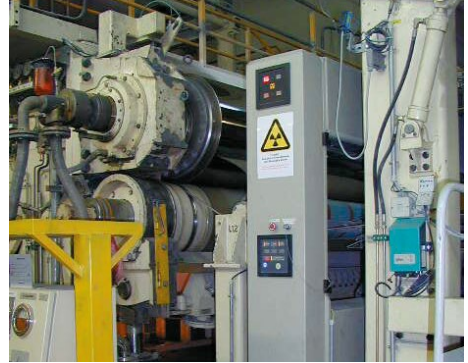
Abb. 42 Am Messrahmen ist die Kennzeichnung angebracht, aus der ersichtlich ist: hier wird ein Strahler eingesetzt.
