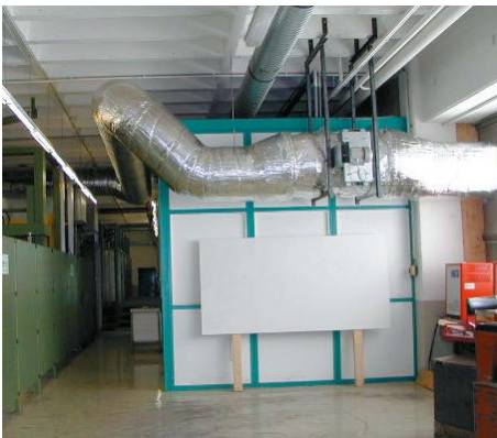
Abb. 40 Durch Verkleiden der Rohrleitung mit geeignetem Lärm-Dämmmaterial lässt sich der Lärmpegel im Raum erheblich senken.
