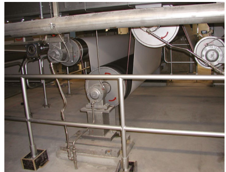
Abb. 1 Die benachbarten Walzen an der Streichmaschine bilden z. T. Einzugstellen. Als Zugangssicherung ist die abgebildete Umweh rung grundsätzlich nicht mehr ausreichend.
