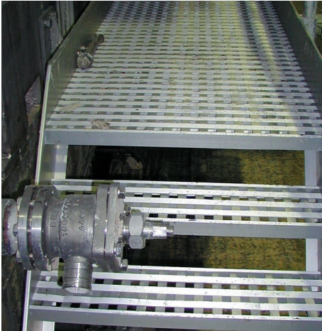
Abb. 17 Ein Anschlussstutzen engt den Durchgang auf weniger als 0,60 m ein. Eine solche Einengung sollte jedoch im Bereich der Treppe nicht vorhanden sein.
