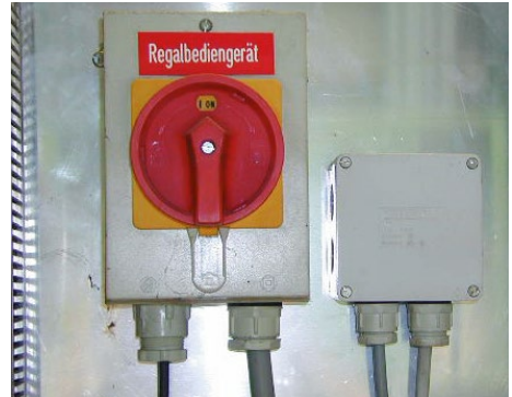
Abb. 28 Dieser Hauptschalter ist eindeutig beschriftet. Er hat außerdem Not-Halt-Schaltvermögen, wie es die Farbgebung in rot/gelb ausweist.
