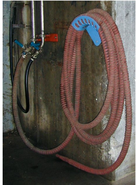
Abb. 34 Der Wasserschlauch (roter Schlauch) ist ordnungsgemäß über die Schlauchaufhängung gelegt. Wenn er gebraucht wird, muss er heruntergehoben werden. Das Gewicht des vollen Schlauches kann erheblich sein. Vielleicht ist das die Motivation für manche Beschäftigte, den Schlauch auf den Boden zu legen.
