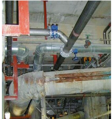
Abb. 21 Handbetätigte Ventile liegen in ca. 5 m Höhe. Vorzuziehen sind von Flur aus zu bedienende Ventile. Werden Anlegeleitern verwendet müssen diese gegen Wegrutschen gesichert werden.
