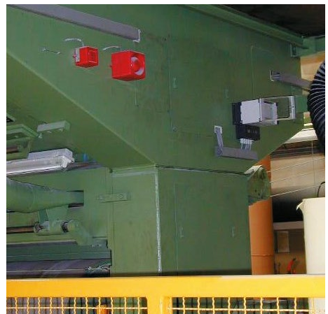
Abb. 24 Der akustische Signalgeber ist auf der Triebseite der Maschine angeordnet. Diese Seite der Maschine kann vom Steuerpult aus nicht eingesehen werden.
