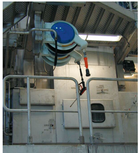
Bild 33 Geeignete Aufrollungen gewährleisten, dass Luft und Wasser an jeder Stelle der Papiermaschine im Bedarfsfall schnell zur Verfügung stehen.
