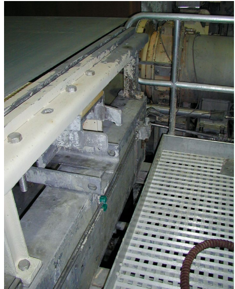
Abb. 22 Die Lücke zwischen Laufsteg und Stuhlung ist kleiner als 120 mm. Im Anwendungsbereich der DIN EN 1034 ist die Maschinenstuhlung als Absturzsicherung ausreichend, wenn die Höhe zwischen Laufstegebene und Sieb mindestens 1,10 m beträgt, An Siebpartien von Altanlagen genüigten noch 0,80 m.
