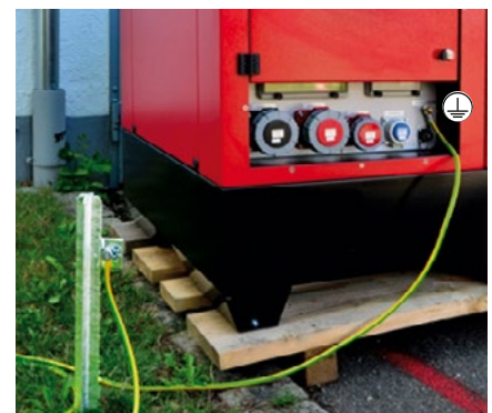
Abb. 15 Stromerzeuger mit Erdungsanschluss und Erdspieß
