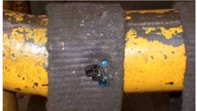
Bild 4-4: Durch heißen Span beschädigte Oberfläche
