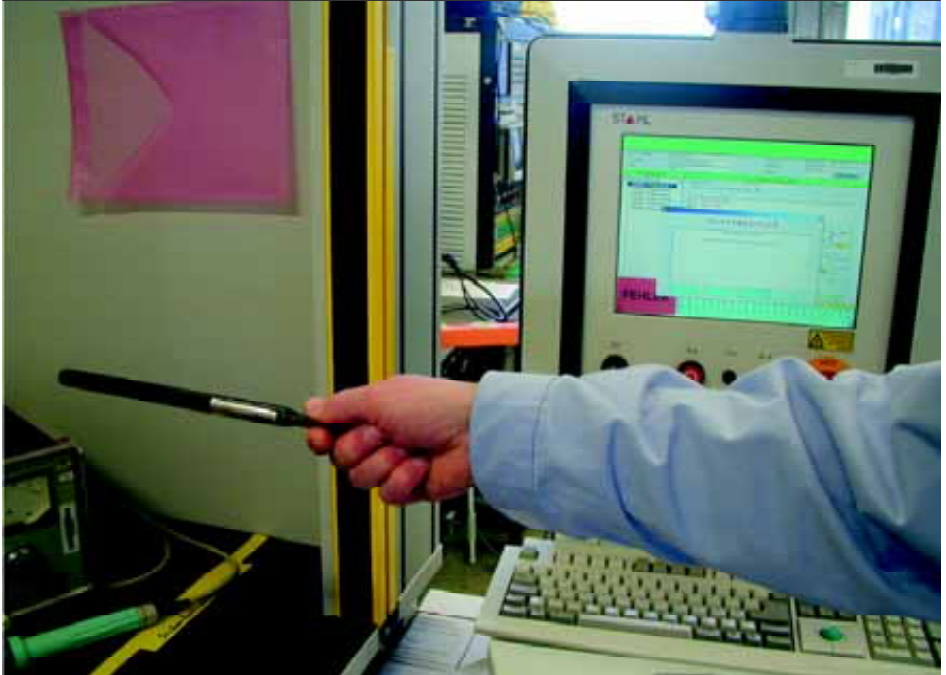
Bild 2: Funktionskontrolle der Sicherheitslichtschranke mittels Prüfstab
