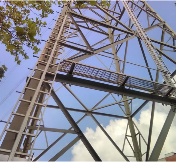
Abb. 12 Beispiel für die Ausrüstung eines Freileitungsmastes mit Bühnen und Zugang über eine Steigleiter. Die Ausrüstung dient insbesondere der Wartung funktechnischer Einrichtungen. Die Sicherung des Zugangs erfolgt mittels mitlaufendem Auffanggerät einschließlich fester Führung.
