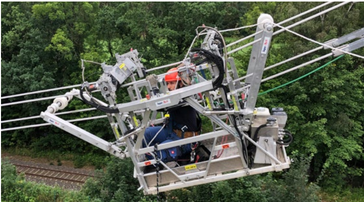
Abb. 129 Beispiel für ein vollständig eingehängtes Leitungsfahrzeug.
