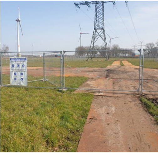
Abb. 148 Beispiel für eine Baustellenabspernung durch einen Bauzaun.
