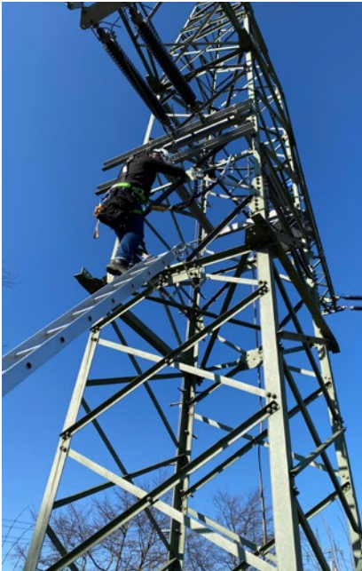
Abb. 82 Die Verwendung der üblichen Masthängeleitern als Zugangsweg zum Eckstiel bietet hier ein hohes Maß an Sicherheit, da durch die Einhängebügel weder ein seitliches Verrutschen noch ein „Absacken“ aufgrund der Bodenbeschaffenheit möglich ist.
