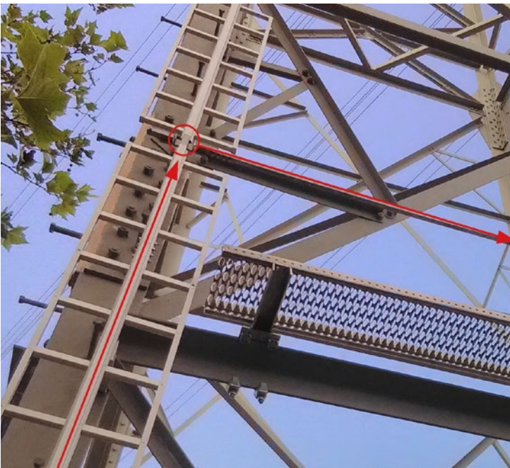
Abb. 13 Die Ausstattung der festen Führung der Steigleiter mit einer „Weiche“ ermöglicht einen ununterbrochenen Schutz gegen Absturz. Das mitlaufende Auffanggerät wird über die „Weiche“ auf die horizontale Anschlagvorrichtung der Mastbühne geführt.
