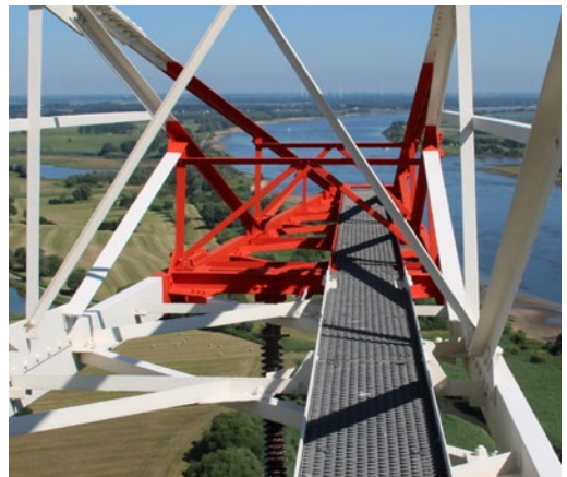
Abb. 5 Gittermasttraverse mit Laufsteg ohne bauliche Einrichtung zum Schutz gegen Absturz.
