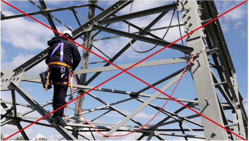
Abb. 39 Beispiel für einen gefährlichen Einsatz eines durch eine bewegliche Führung verlängerten Verbindungsmittels. Im Falle eines Absturzes ergibt sich eine Sturzhöhe von deutlich über 4 m. Zusätzlich gerät der Versicherte in eine Pendelbewegung mit Aufprall auf die Mastkonstruktion. Der Versicherte hat einen Schutzhelm mit einem 4-Punkt-Kinnriemen zu benutzen.
