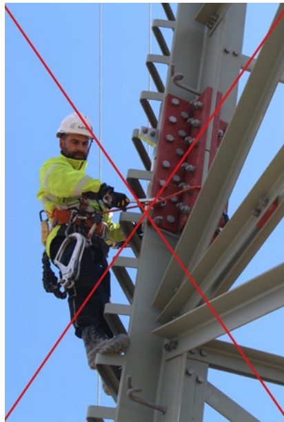
Abb. 34 Achtung: Keine Absturzsicherung, da der Auffanggurt nur in Haltefunktion eingesetzt wird.
