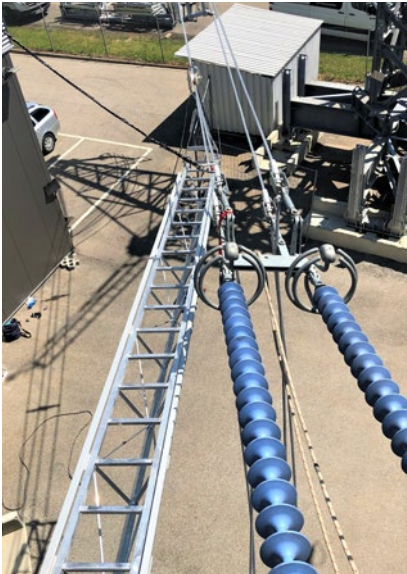
Abb. 105 Montagebühne mit integrierter Anschlagseinrichtung – hier als Schienensystem nach DIN EN 795 Typ D.
