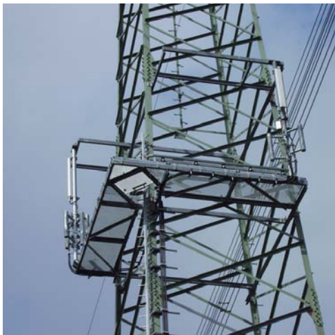
Abb. 6 Beispiel für die Ausrüstung eines Freileitungsmastes mit Wartungsbühnen und festen Führungen zum kollektiven Schutz gegen Absturz. Die Ausrüstung dient insbesondere der Wartung funktechnischer Einrichtungen.
