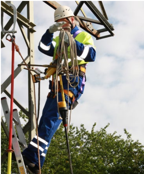
Abb. 93 Beispiel für den Einsatz einer Sprossenanlegeleiter an einem Gittermast. Der Schutz gegen Absturz erfolgt durch geeignete PSAgA, wie z. B. durch mitlaufende Auffanggeräte einschließlich beweglicher Führung. Um ein sicheres Arbeiten und einen sicheren Materialtransport, hier Hochziehen eines Spannungsprüfers, zu gewährleisten ist der zusätzliche Einsatz eines Halteseils unverzichtbar.
