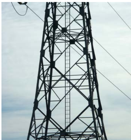
Abb. 7 Beispiel für einen Zugangsweg im Mastschaft durch eine zweiholmige Steigleiter. Die Steigleiter ist mit einem gespannten Stahlseil als fester Führung ausgerüstet.
