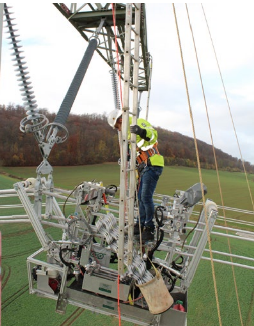
Abb. 123 Zustieg zu einem einzuhängenden Leitungsfahrzeug über eine Hängeleiter im Bereich einer Hängekette.
