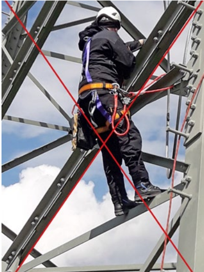
Abb. 35 Im Bildbeispiel gibt es keinen Schutz gegen Absturz. Es fehlt eine Sicherung über den Auffanggurt in der Auffangfunktion. Die Befestigung des Halteseils an einer Halteöse kann im Absturzfall zu erheblichen Verletzungen des Versicherten führen.
