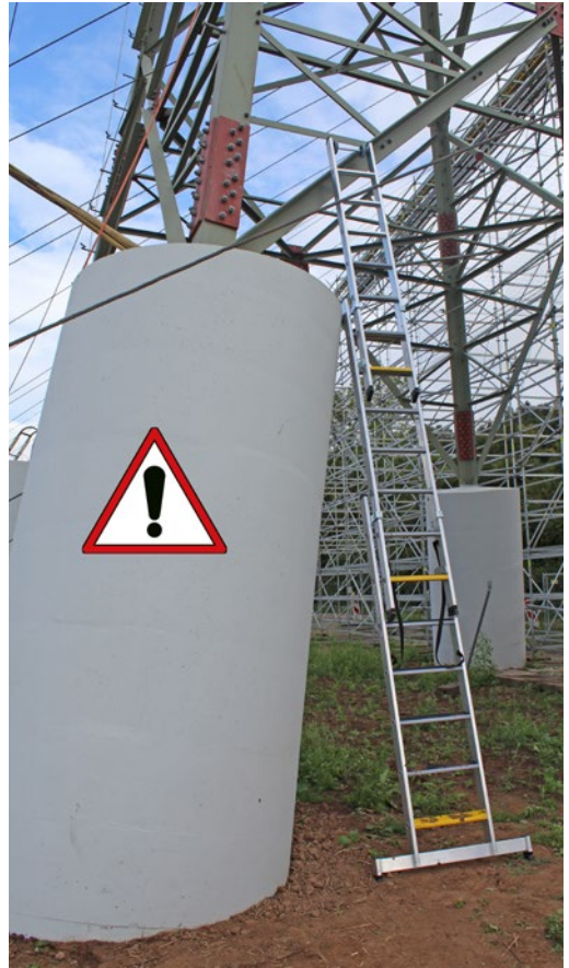
Abb. 81 Aufgrund des weichen aufgeschütteten Bodens ist ein sicherer Stand der Anlageleiter nicht gewährleistet.
