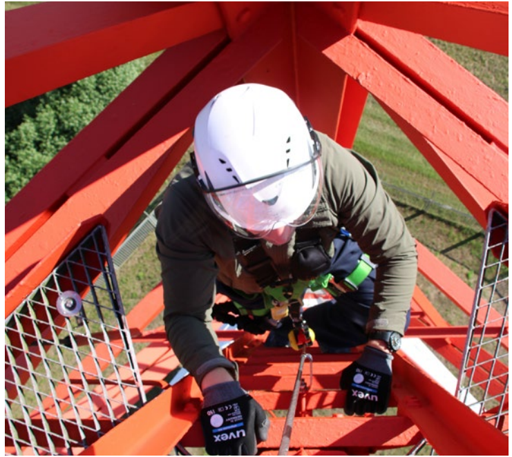
Abb. 10 Beispiel für eine innenliegende Steigleiter mit Stahlseil als feste Führung.
