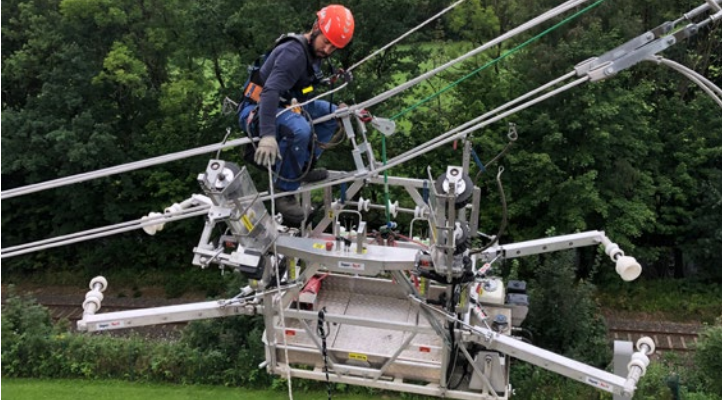
Abb. 128 Beispiel für ein hochgezogenes Leitungsfahrzeug unmittelbar vor dem Einhängen in ein Leiterbündel.
