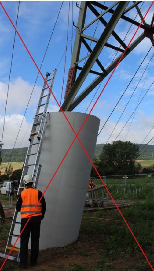
Abb. 80 Der Leiterkopf am Betonfundament bietet keinen sicheren Halt gegen seitliches Verrutschen und kein sicheres Übersteigen zum Mast. Trotz Einhaltung der Mindeststandbreite am Leiterfuß kann kein sicherer Stand erreicht werden.
