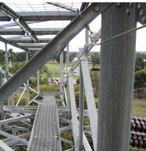
Abb. 97 Beispiel für einen Laufsteg/ Gitterrostgang sowie einer horizontalen Anschlageinrichtung mittels Stahlseil auf einer Traverse.
