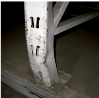
Abb. 12 Gerissene Schweißnaht an der Fußplatte der Stütze
