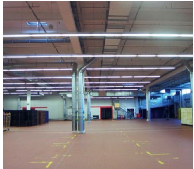
Abb. 3 Hallenbe- und Hallenentlüftungsanlage Zur Umsetzung von Schichtenströmung wird die Zuluft über bodennah positionierte zylinderförmige Quellluftdurchlässe in die Halle eingebracht.
